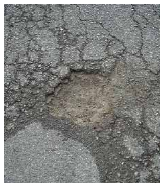
路面破損穴（ポットホール）
