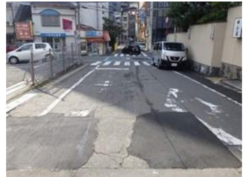
補修が必要なひび割れた老朽化路面の例
